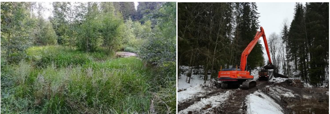
Kuva 8. Myös Kurhilan altaiden yläosan altaat olivat täyttyneet (vasen kuva). Tyhjennysurakassa haastetta aiheutti jyrkkä ajoluiska (oikealla).
