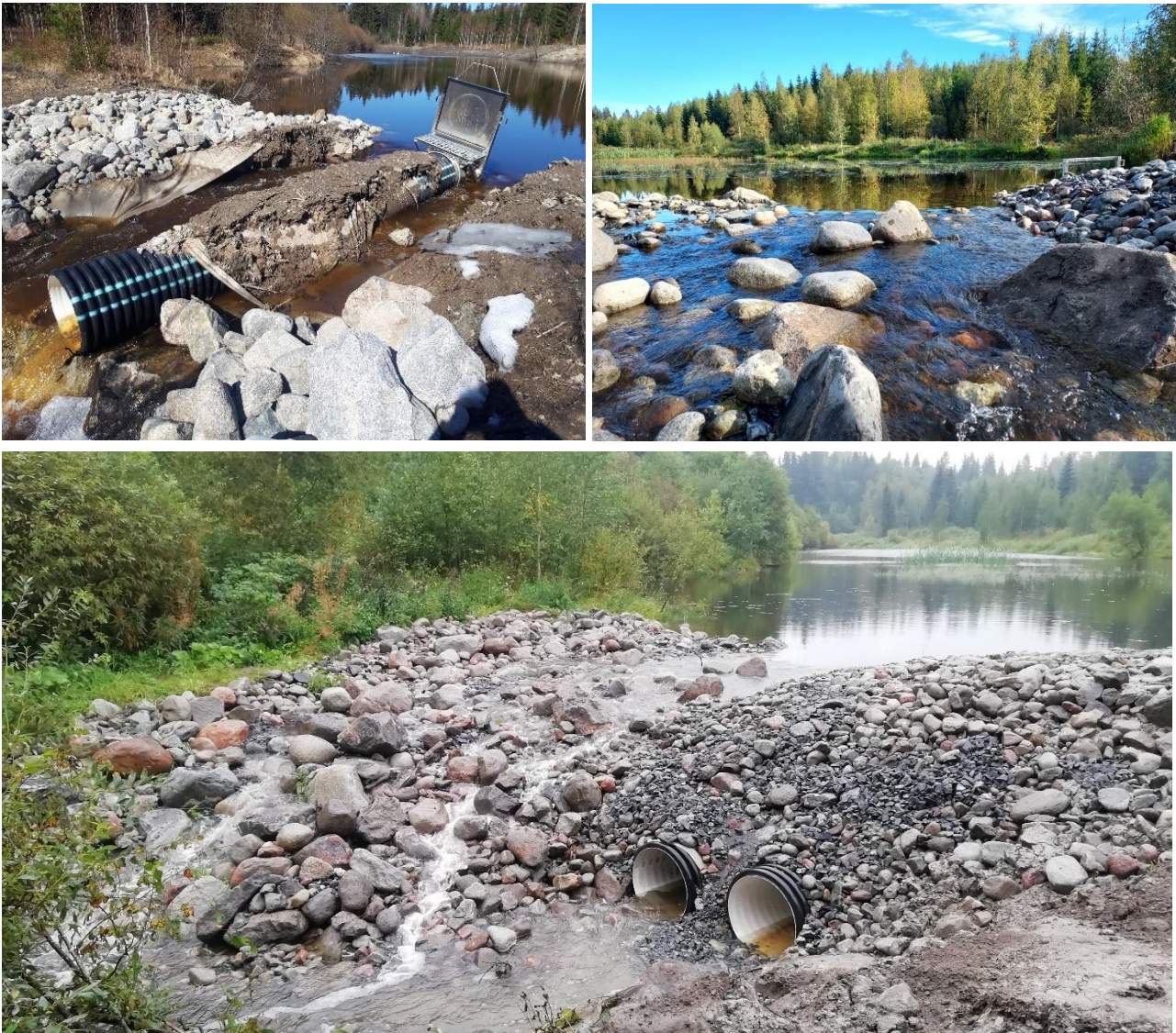
Kuva 22. Ylhäällä vasemmalla tilanne keväällä 2023, kun pato oli kevättulvan myötä murtunut. Oikealla ja alhaalla uudelleen korjattu pato loppukesällä 2023.
